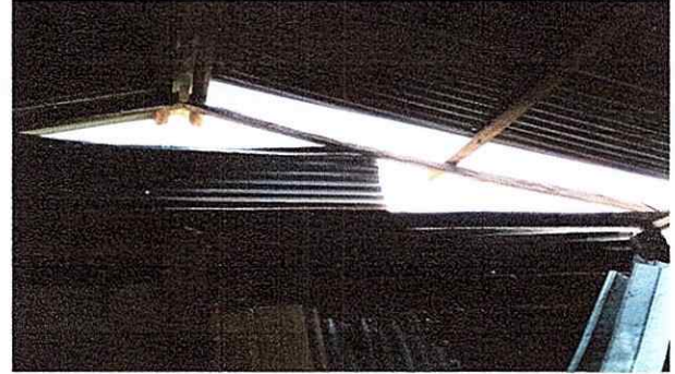
Foto 2: La estructura de madera ya esta por colapsar por el daño
