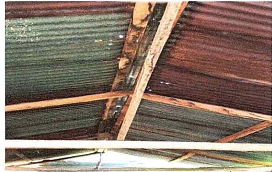
Foto 4: las vigas de madera y las laminas ya estan deterioradas
