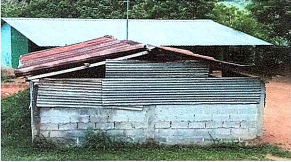
Foto1: . Foto del daño de techo del aula
