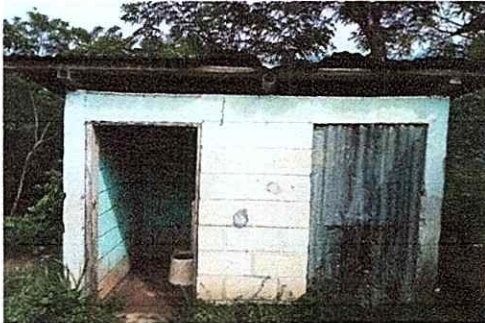
Foto 5: Las puertas, el techo y pintura de los baños necesita remozamiento
