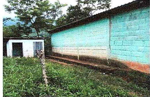
Foto 6: Una de las areas del perimetro del establecimiento que necesita circular con malla
